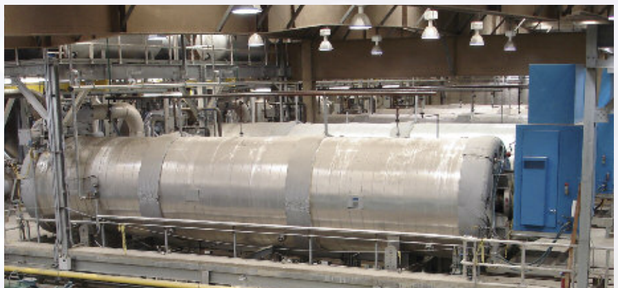
Anlage für die Klärschlammrocknung in den USA
