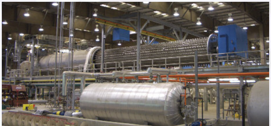
Klärschlammrockner mit ausgefahrenem Rotor
