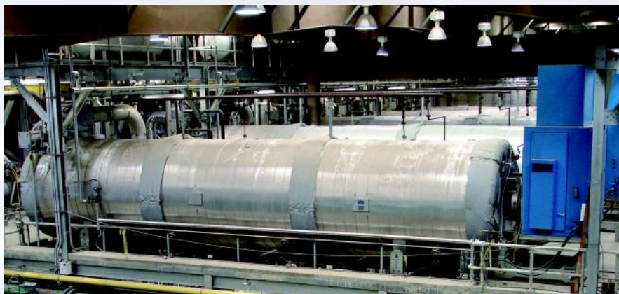
Secador de Lodos em Planta no USA
