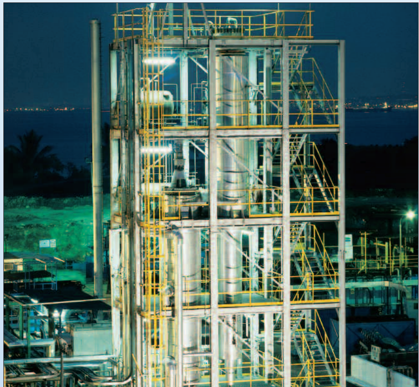
Slop-Oil, Entwässerung und Destillation (Singapur).
